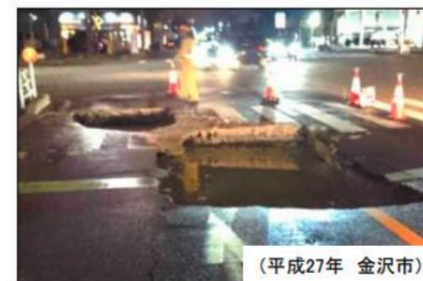
管路施設起因事故例
