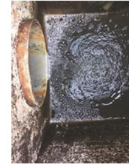
沈殿槽なしで河川放流
