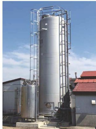
オゾン反応槽と生物処理槽
