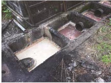
導入前の排水
